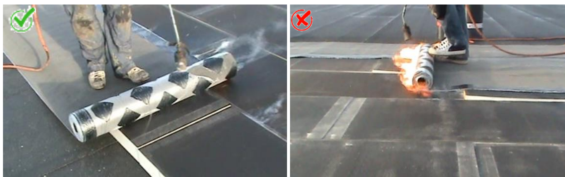
11 11: Tvirtinimas degikliu ant „Eurothane Bi-4“ plokščių (Kairėje: teisingas tvirtinimas – iš dalies priklijuotas pagrindo sluoksnis, pritvirtintas prie hidroizoliacinio ritinio; Apačioje: neteisingai naudojimo sritis – pritvirtintas ant izoliacinio paviršius)
