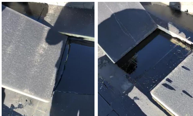
14. attēls: Izolācijas plāksnes uzklāšana uz pamatnes - karsta bitumena izklāšana ar izolācijas plāksni
